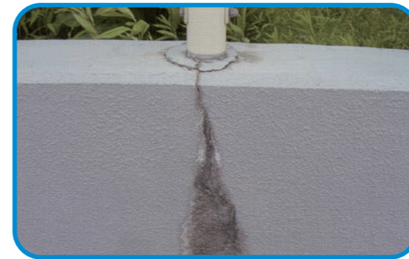
手摺り部分のひび割れ
