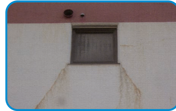
外壁のひび割れ
