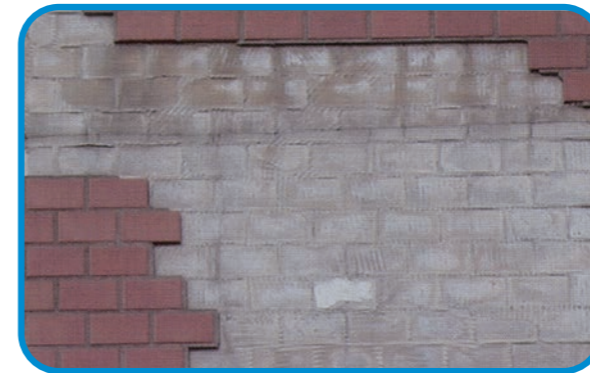
タイル張り外壁の浮き
