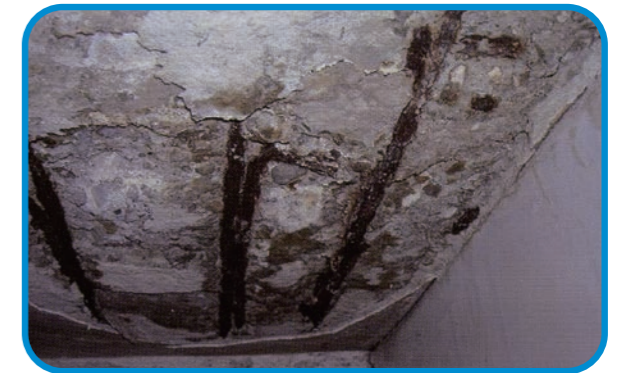
コンクリートの露筋、欠損
