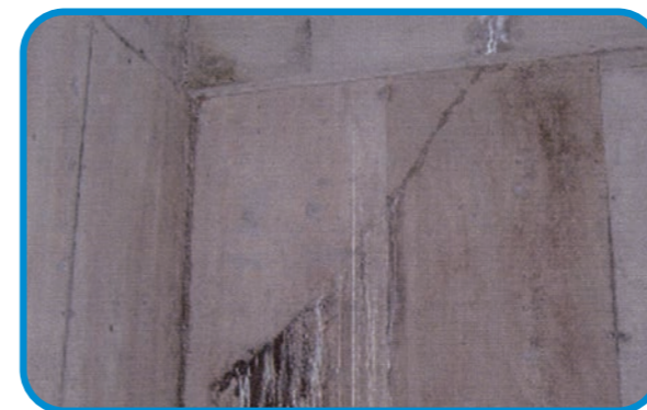
ひび割れからの漏水
