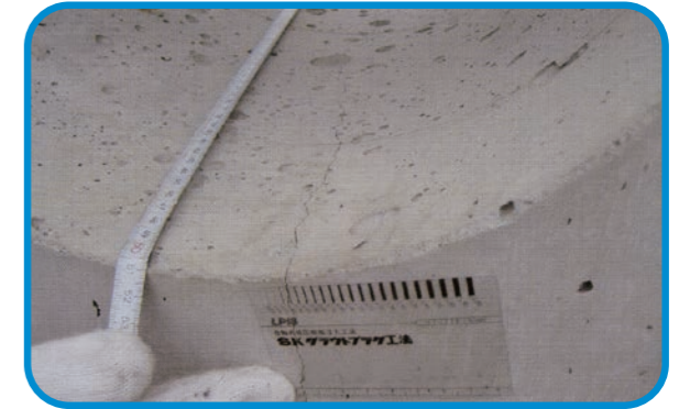
コンクリート構造物のひび割れ
