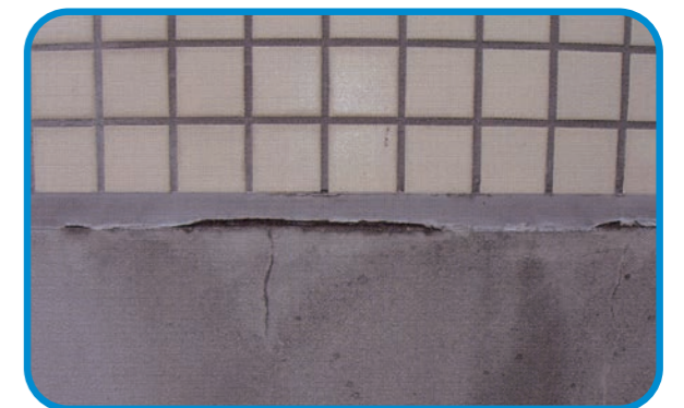
シーリング材の劣化・剥離
