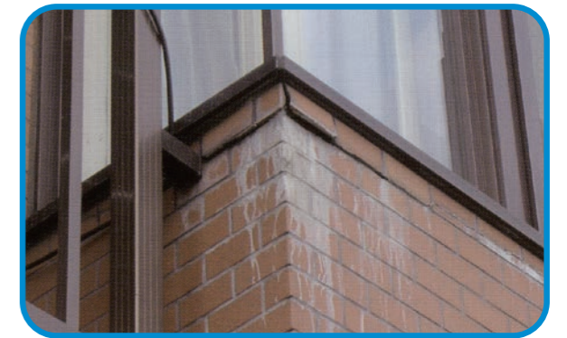
サッシ廻りタイルの浮き
