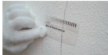
2. ひび割れ測定
